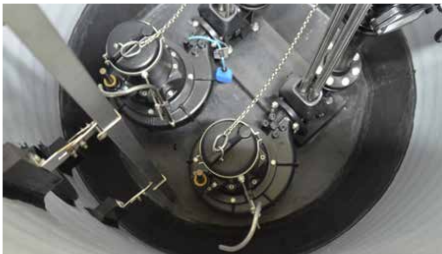
► Pumpen mit Spülrohr
