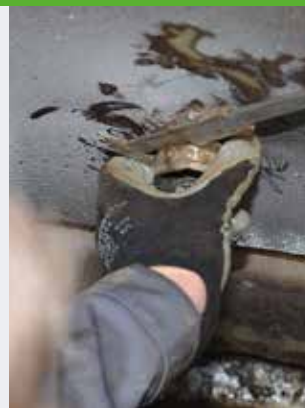
► Kürzen des Druckabgangs im Schacht
